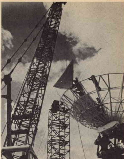
Alcuni tecnici sono intenti ad installare i pannelli dell'antenna destinata alla stazione terrestre per satelliti dell'isola di Ascensione.
