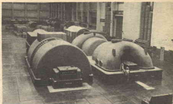
I gruppi turboalternatori raffigurati nella fotografia riprodotta qui sopra sono in grado di generare potenze fino a 360.000 kW (360 milioni di watt).
