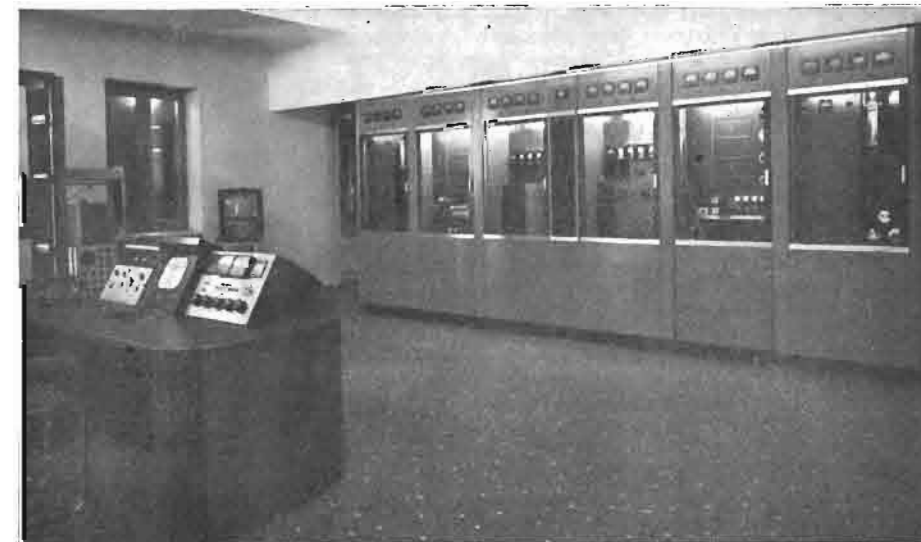
Interno del trasmettitore RAI-TV di Monte Penice.
