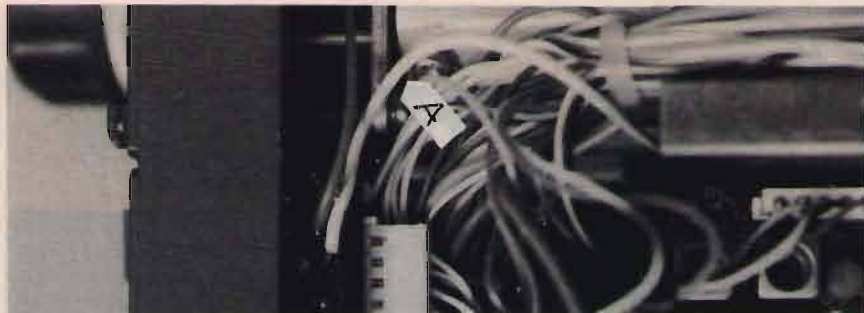
⑦ La scheda switch B dove si collega il filo "A" per la commutazione con il FIX.
